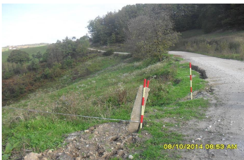
Slika 5. Klizište na Lokalnom putu Radoč-Čava
