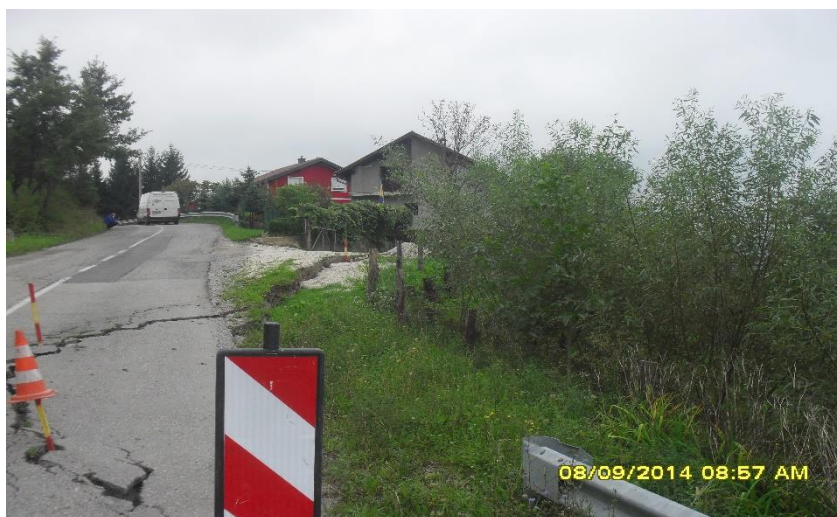
Slika 1. Klizište u Mjesnoj zajednici Konjodor na RP 401 b.
